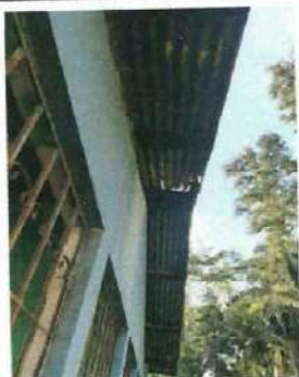
Foto 3: Sustrucción de lámina deteriorada.
